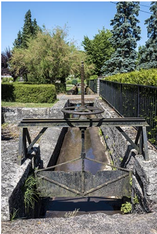
Vanne située en aval sud de la remise de matériel d'incendie, à l'entrée du village. 70, Ferrières-lès-Scey
