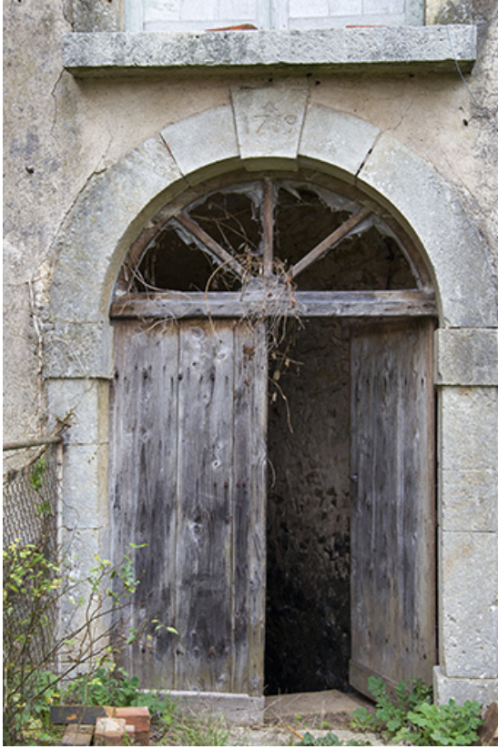
Porte donnant accès à la cave sous le bâtiment du XVIIIe siècle. 70, Ferrières-lès-Scey
