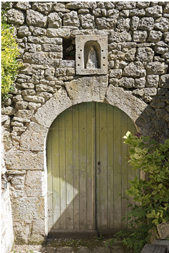
Cave du couvent : niche datée 1710 en réemploi au-dessus de l'entrée. 70, Rupt-sur-Saône, lieudit : les Minimes
