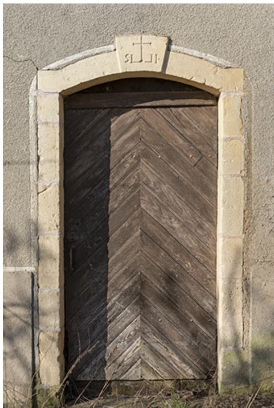
Porte d'entrée ornée d'une clé portant inscription dans le linteau. (Détail de la maison 2 rue du Château) 70, Cendrecourt
