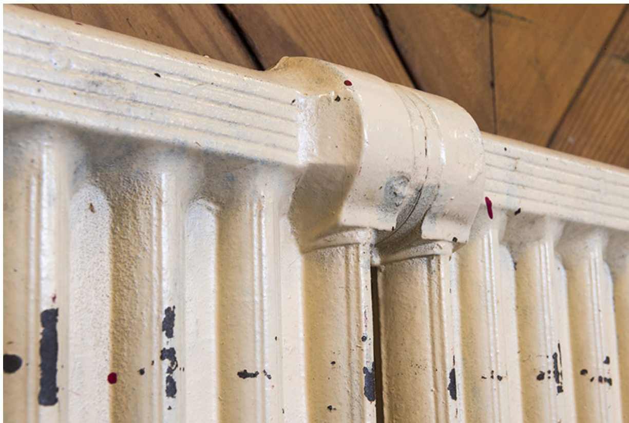
Détail d'un des radiateurs en fonte.
