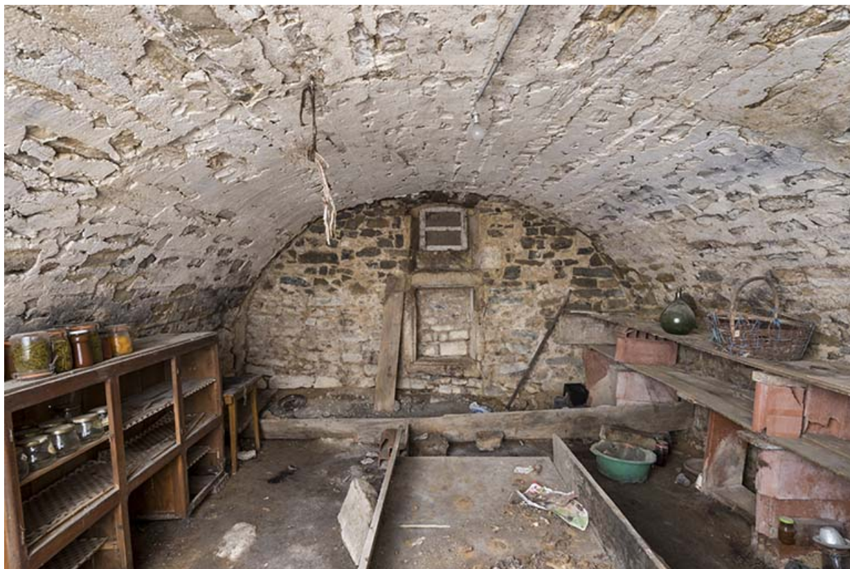
Vue de la cave médiane, dont l'entrée en façade est orientée à l'Est 70, Baulay, 32-34 Grande Rue
