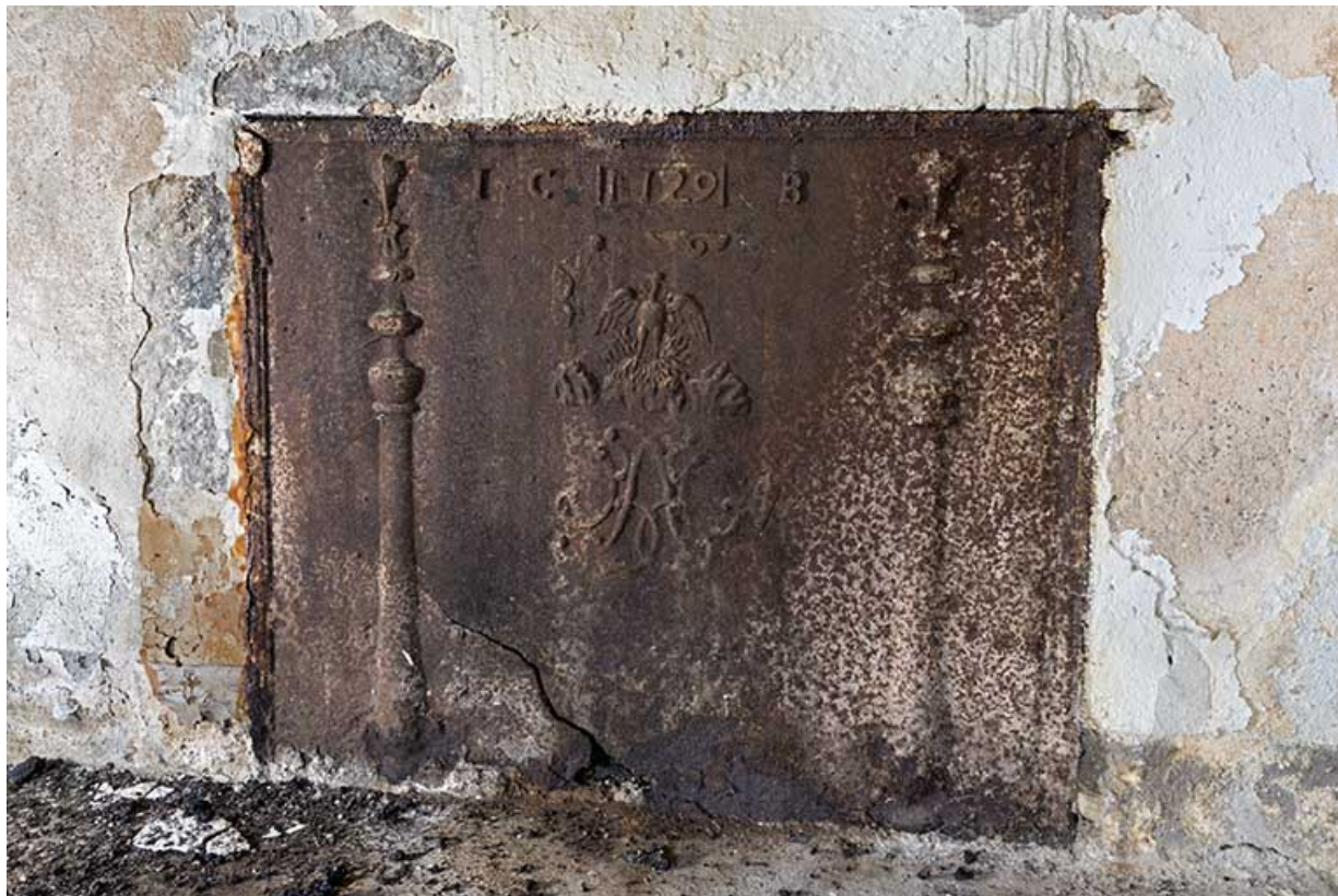
intérieur : la plaque de cheminée.
