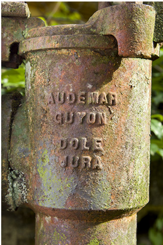
Pompe à eau : inscription concernant le fabricant (Audemar Guyon à Dole, Jura). 70, Rupt-sur-Saône, 5 rue de la Garenne
