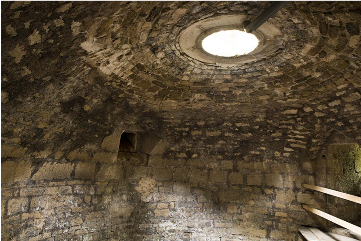
Dans la tour ouest. Vue rapprochée de la partie sommitale depuis l'intérieur. 70, Demangevelle
