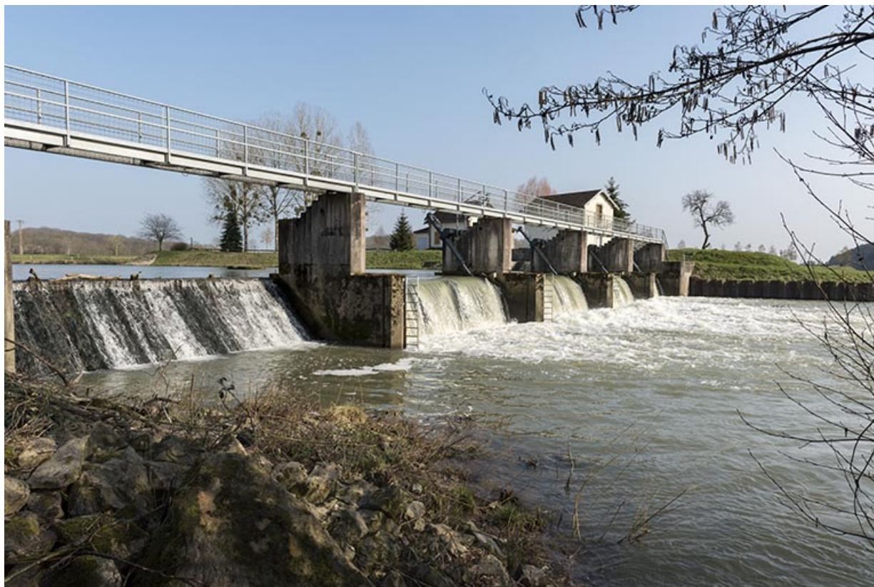
Le barrage mobile de Montureux-lès-Baulay. 70, Montureux-lès-Baulay
