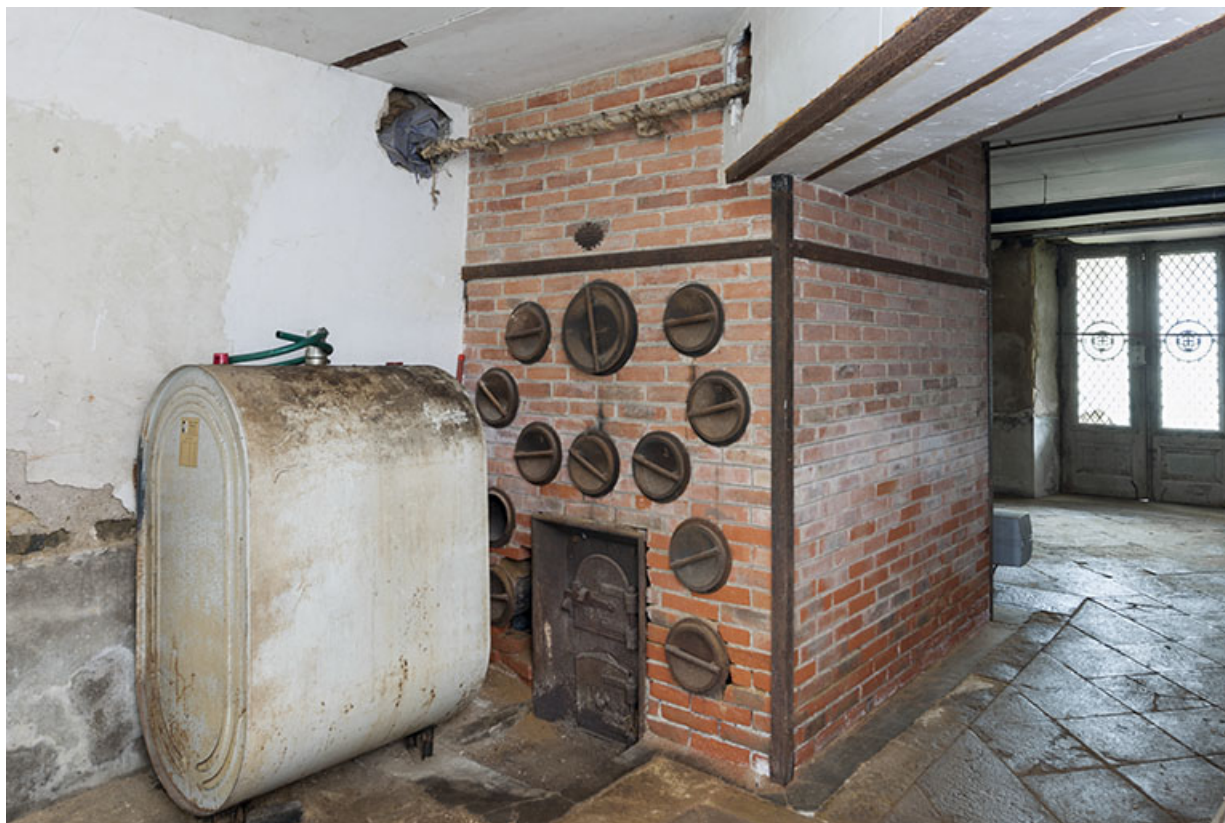
L'ancien chauffage centrale du château.
