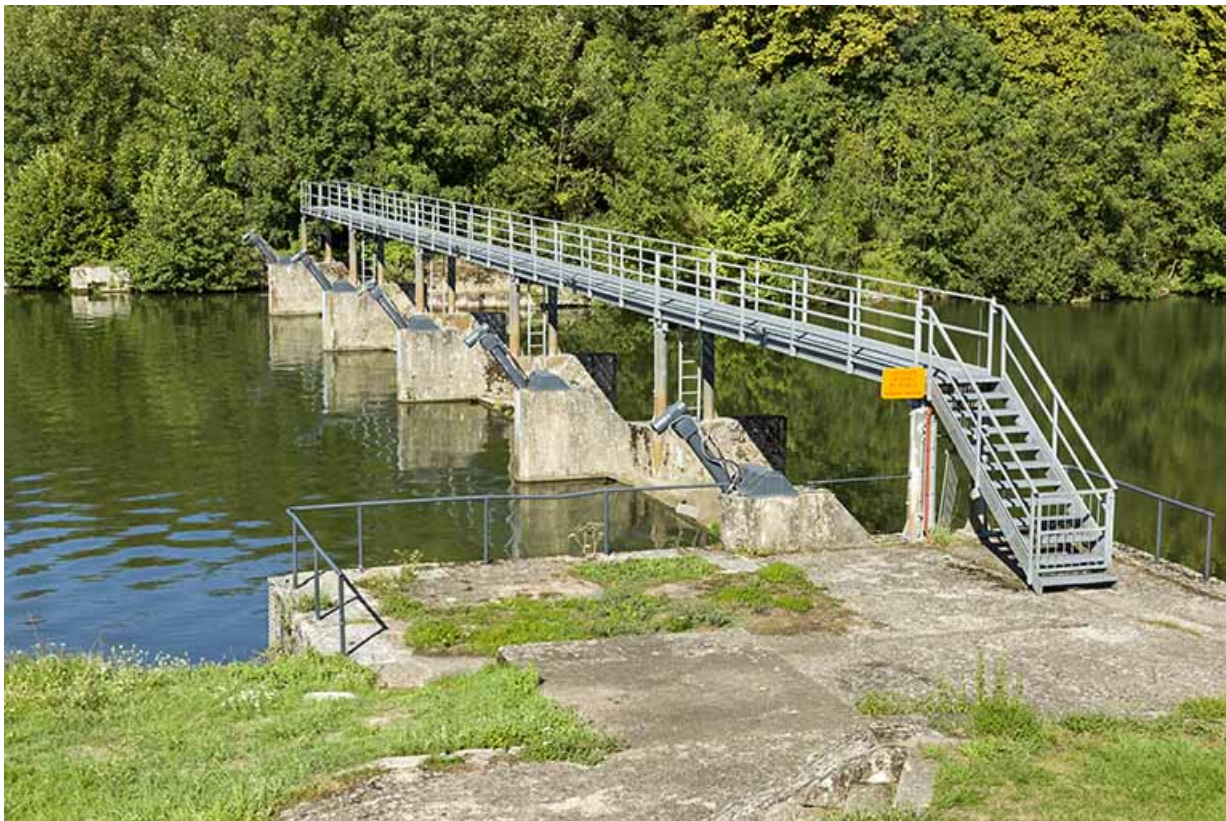
Vue de trois-quart du barrage depuis la rive droite en amont. (nord-ouest) 70, Ferrières-lès-Scey
