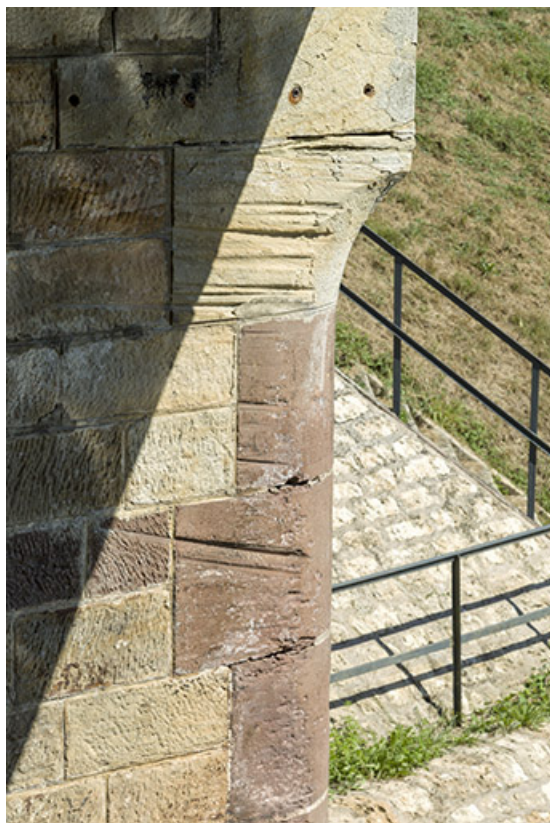
Traces d'usure dans les maçonneries de l'écluse (aval).
