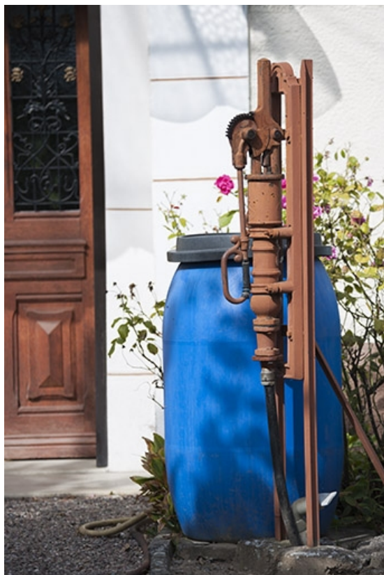
Pompe à eau manuelle.
