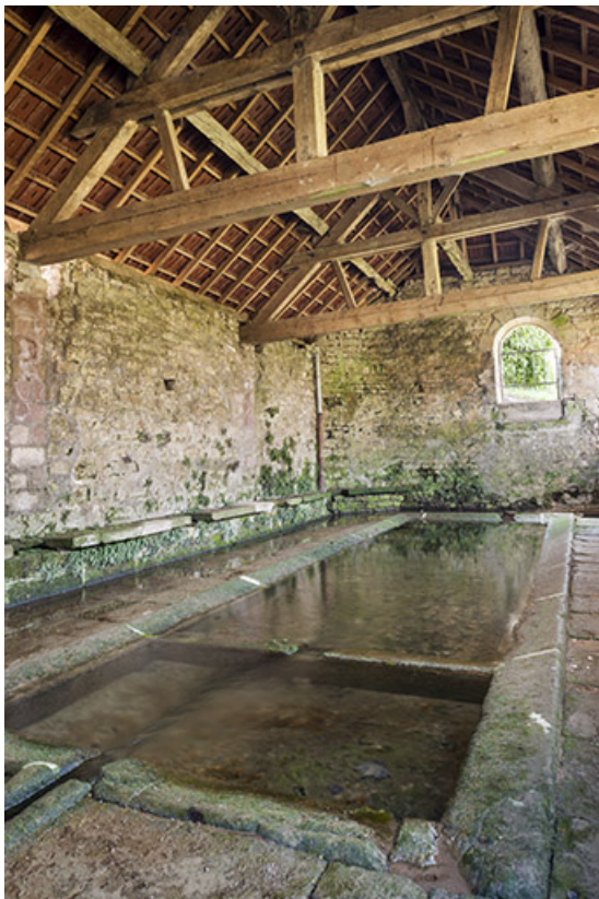
Vue générale des bassins.
