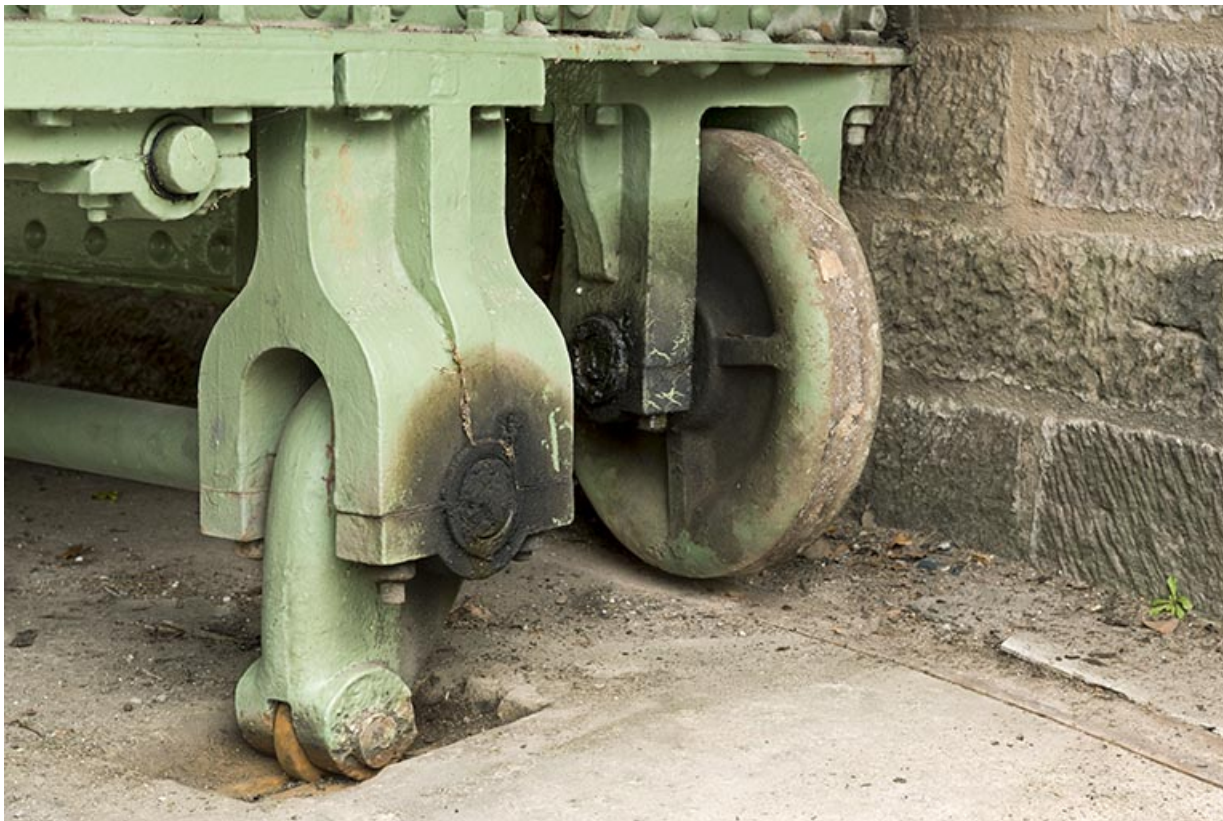
Système de calage baissé (côté amont).
