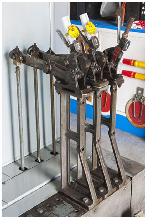
Gare de Port-d'Atelier, poste d'aiguillage : manettes de commande. 70, Faverney
