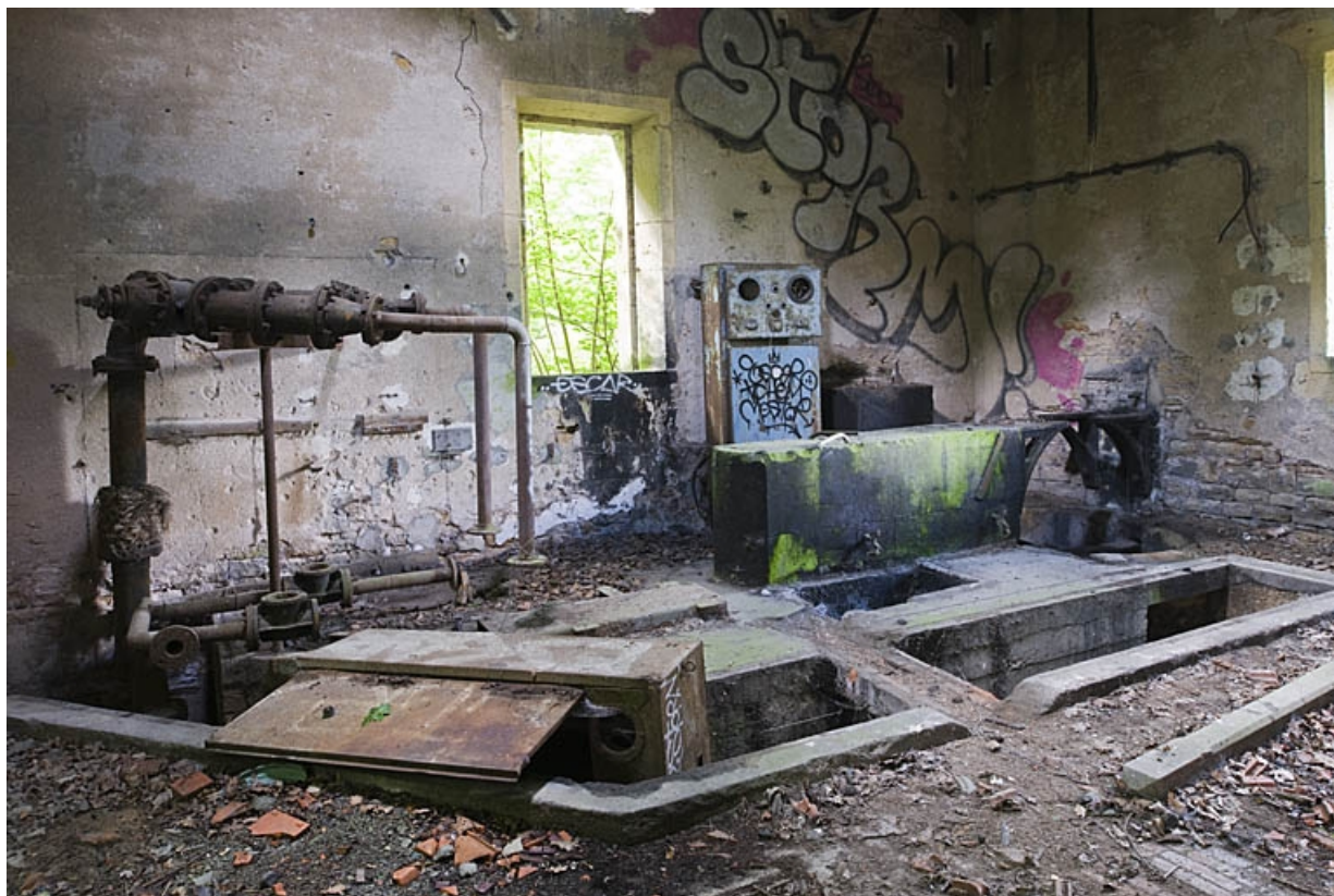
Station de pompage : Intérieur.
