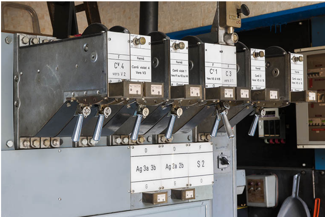
Gare de Port-d'Atelier, poste d'aiguillage : manettes de commande de la signalisation. 70, Faverney
