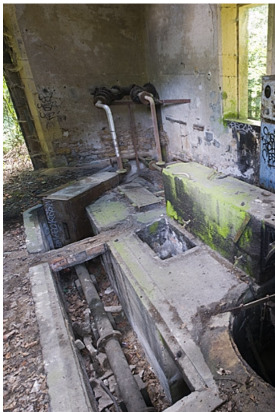
Station de pompage : détail de l'intérieur. 70, Favorney
