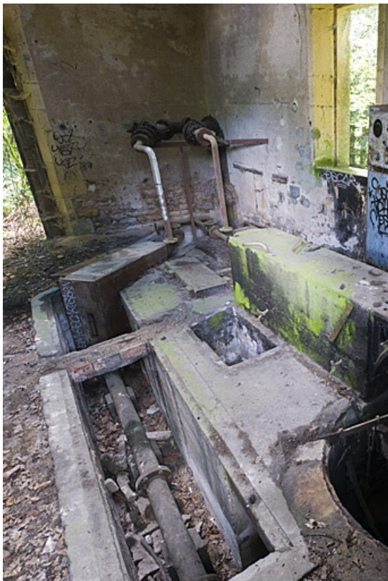
Station de pompage : détail de l'intérieur. 70, Favorney
