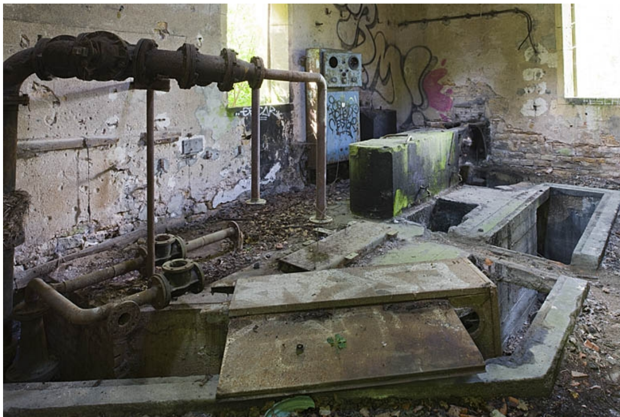
Station de pompage : vue rapprochée de l'intérieur.
