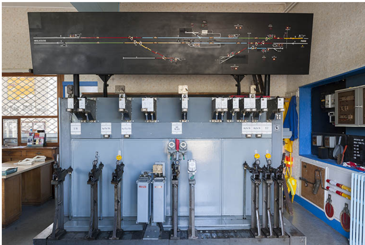
Gare de Port-d'Atelier : intérieur du poste d'aiguillage. 70, Faverney
