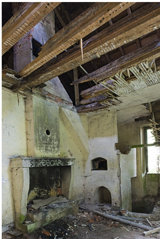
Station de pompage : logement du technicien chargé de l'entretien de la machine à vapeur. 70, Favorney
