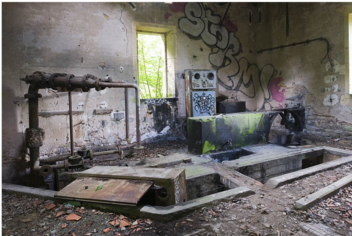
Station de pompage : Intérieur.
