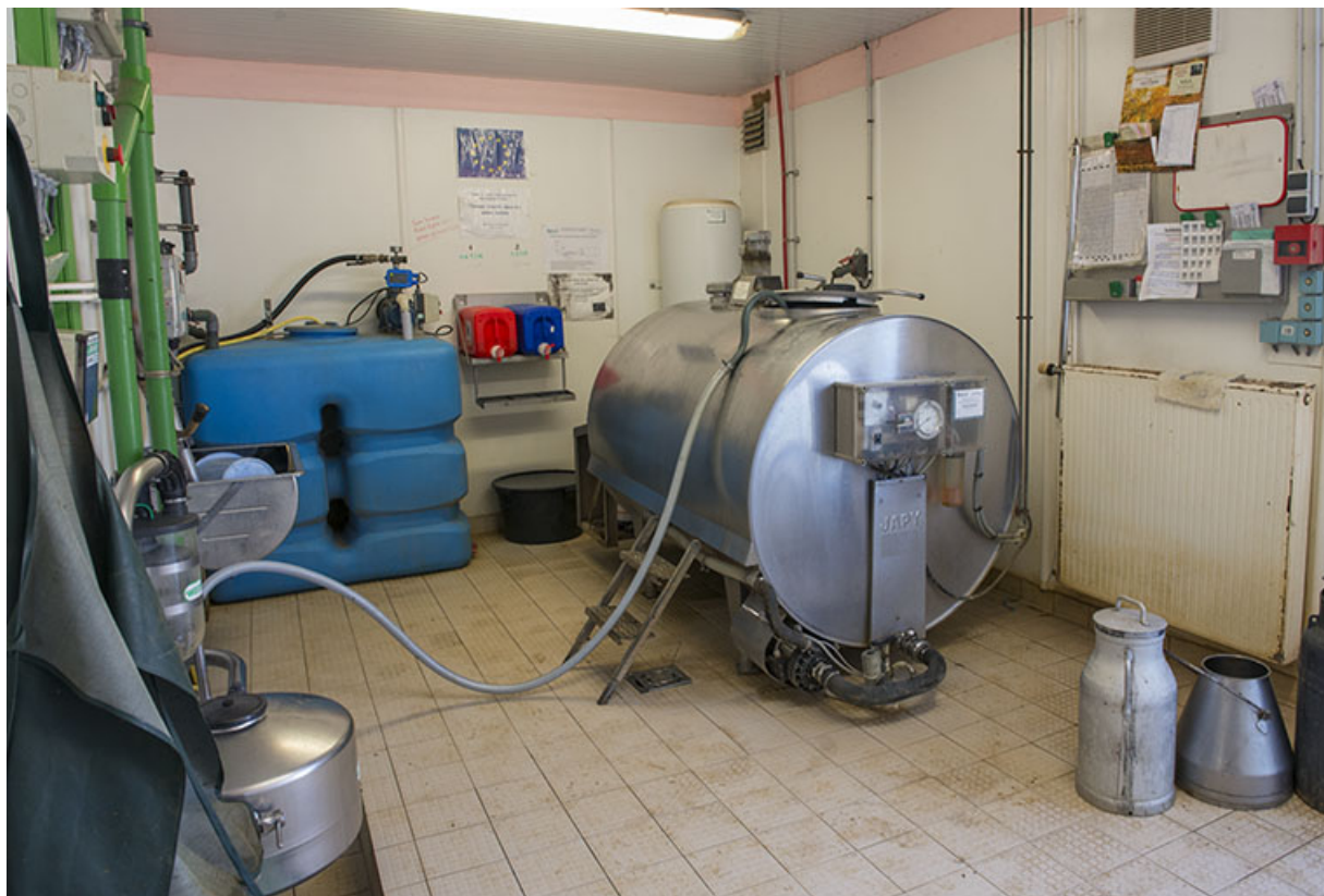
Tank à lait dans le bâtiment de production laitière.
