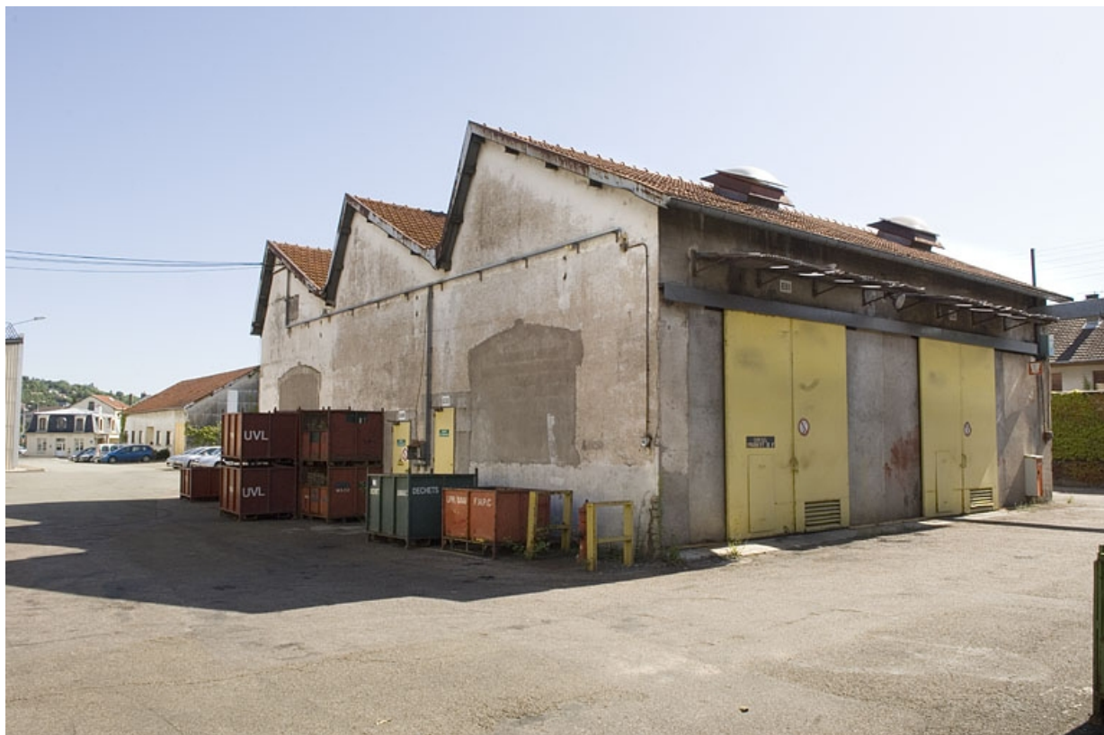
Salle des machines et chaufferie (usine Dollé).
