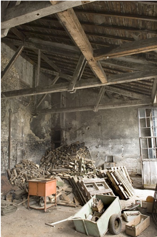
Intérieur de l'atelier à flanc de colline. Vue depuis le nord. 70, Arc-lès-Gray, 20 avenue Jean Jaurès
