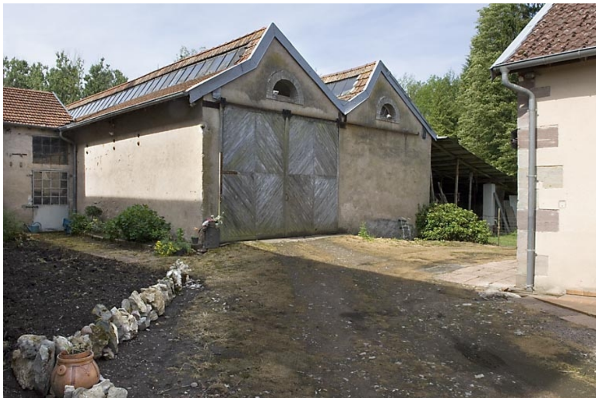
Extension ouest (atelier de fabrication ?). 70, Citers rue de la Hache, lieudit : la Hache
