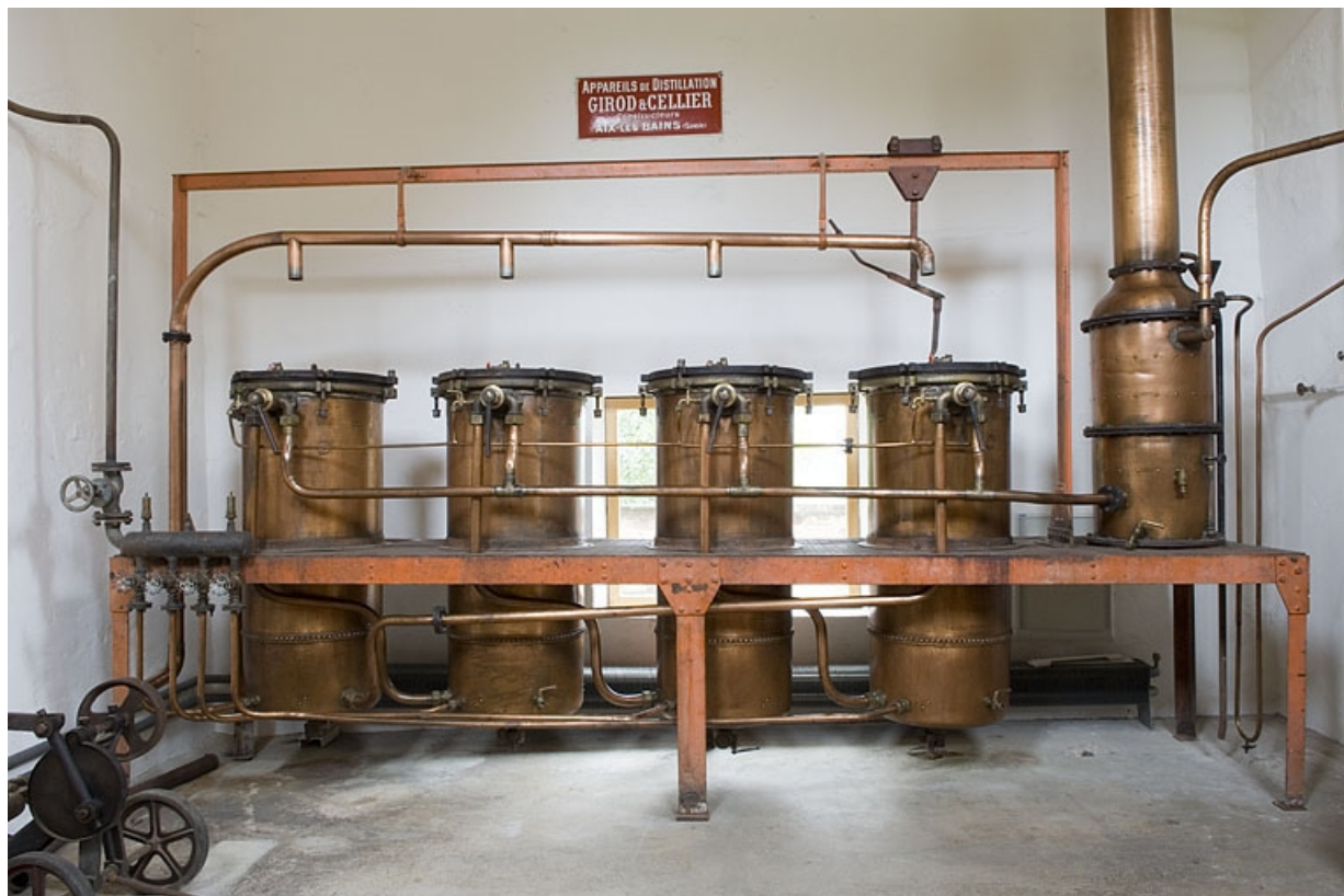
Salle de distillation. Alambics Girod et Cellier (Aix-les-Bains).
