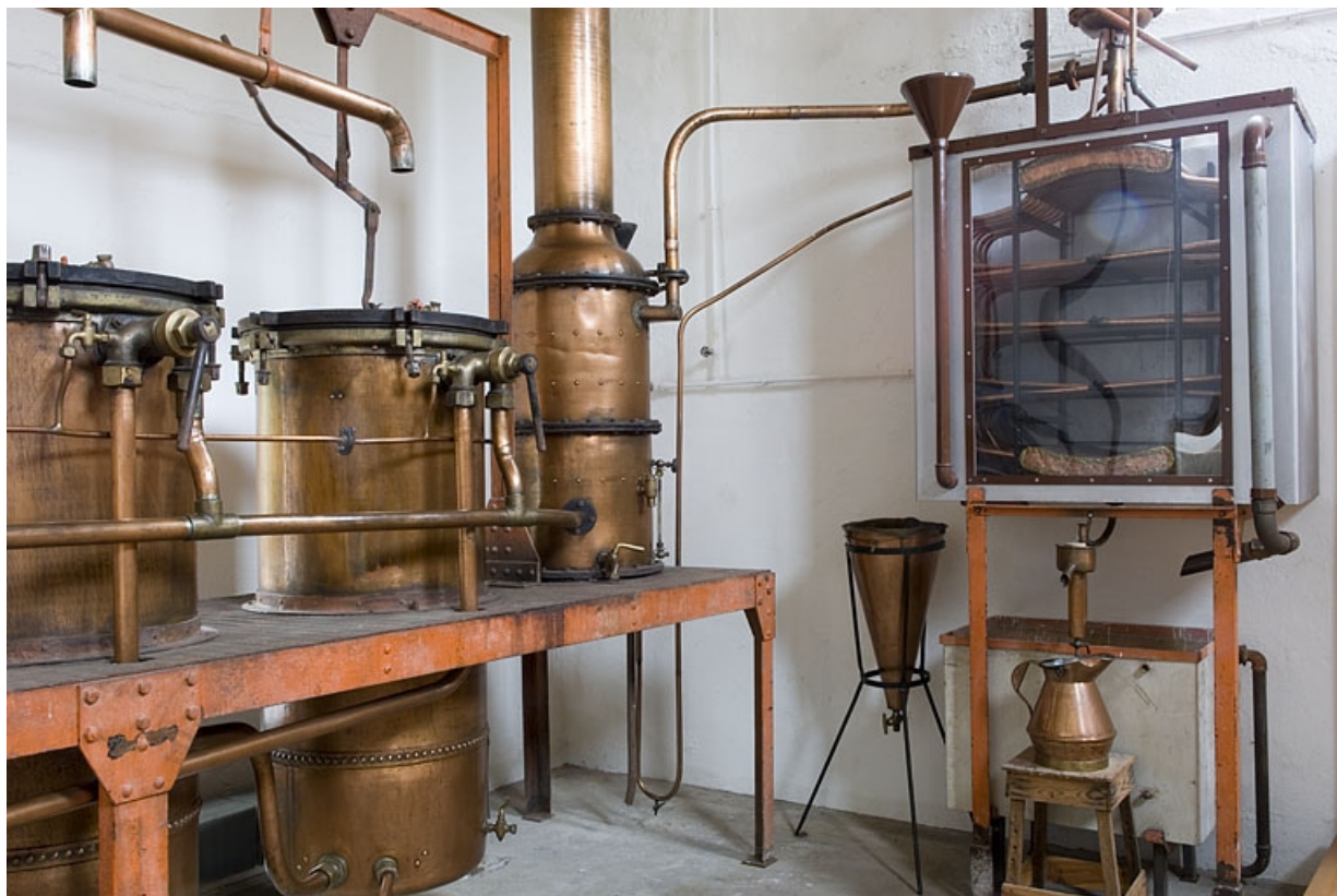
Salle de distillation. Alambics, colonne de rectification et réfrigérant. 70, Fougerolles, lieudit : le Petit Fahys
