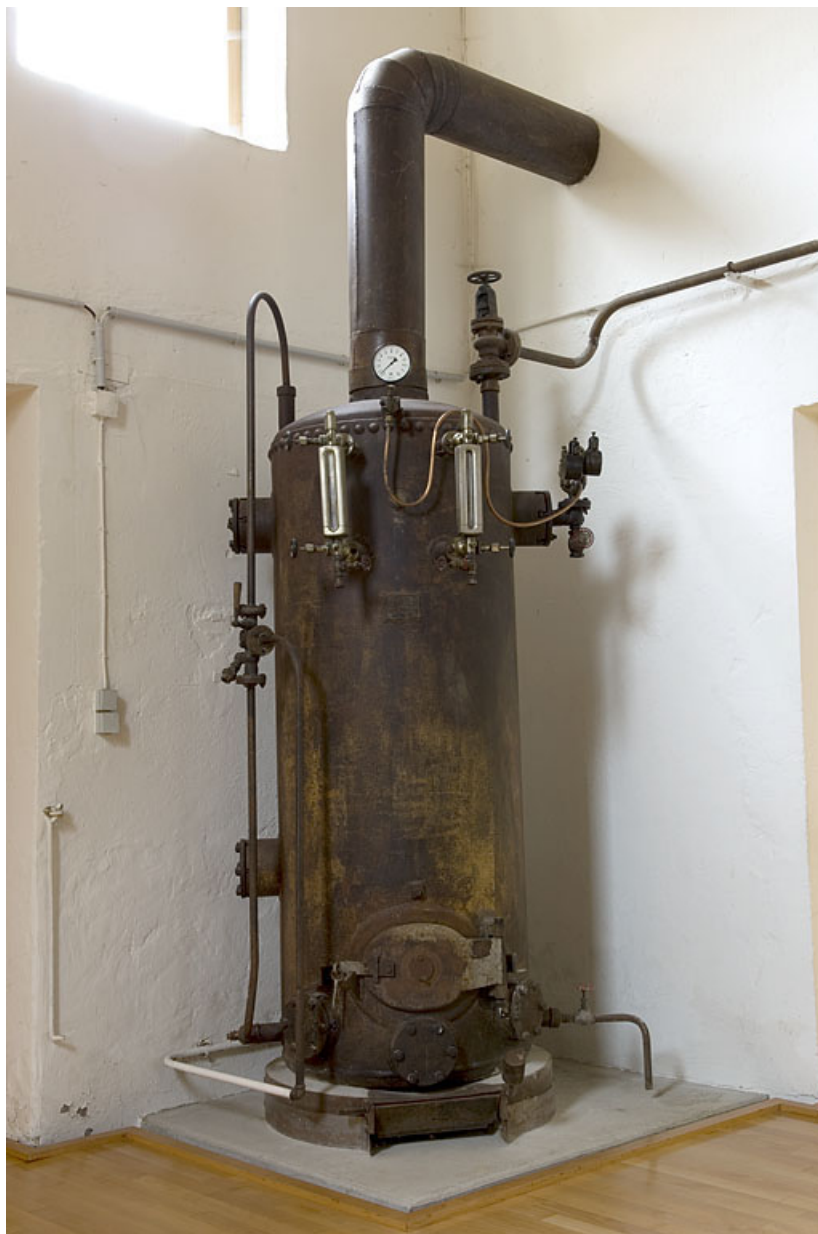
Salle de distillation. Chaudière Thiébaud (Trévillers).
