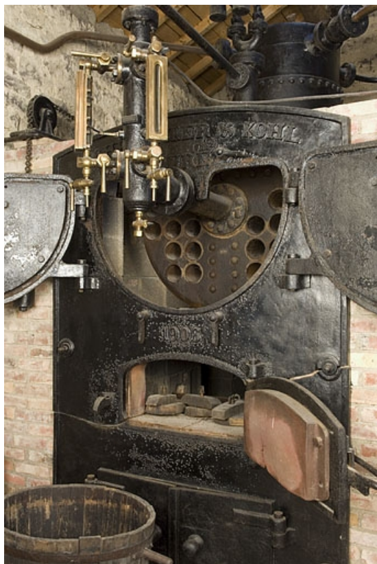
Chaudière Scheidecker et Kohl (Lure). Détail de la façade. 70, Fougerolles, lieudit : le Petit Fahys
