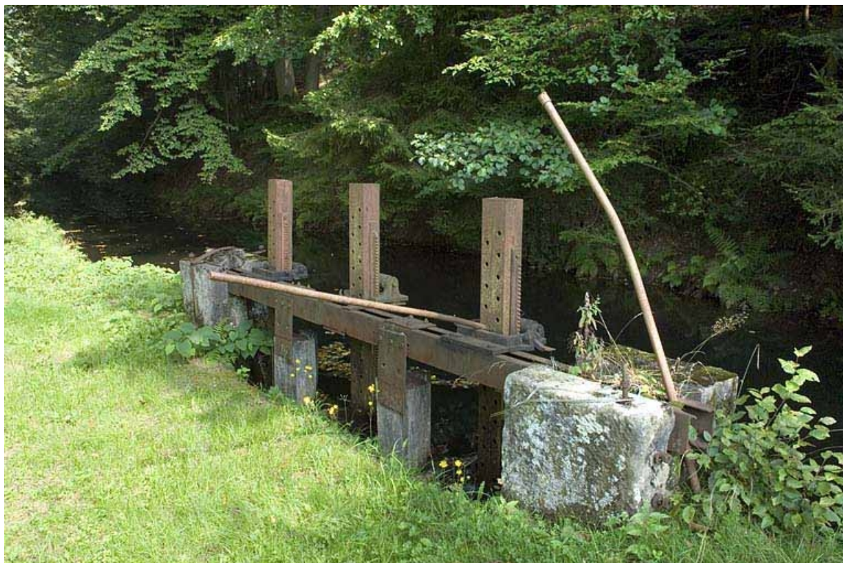
Vanne de décharge sur le bief d'amenée.
