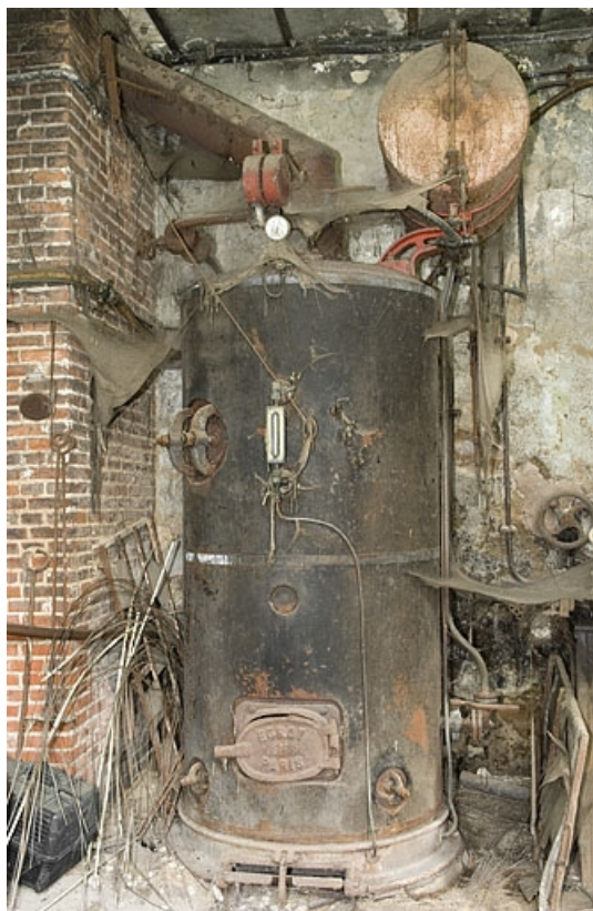
Atelier de distillation. Chaudière Egrot.
