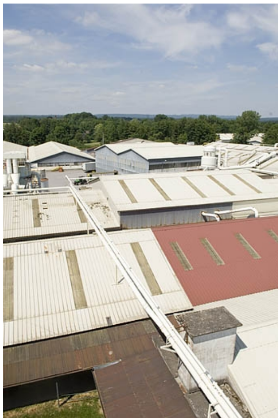
Toitures de l'usine de meubles, vers le nord-est (cadrage vertical). 70, Saint-Loup-sur-Semouse, 15 avenue Jacques Parisot
