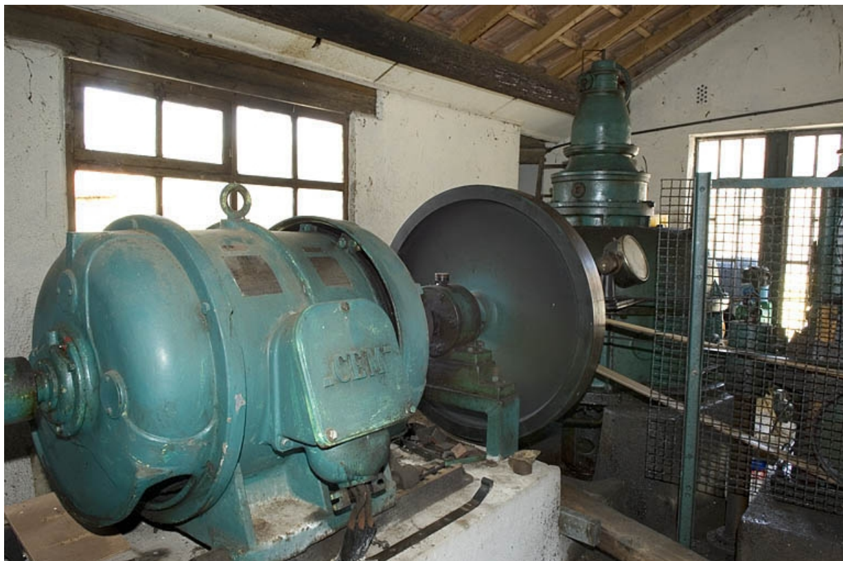
Intérieur de la salle des machines (sud). Alternateur CEM. 70, Pont-du-Bois, lieudit : la Forge
