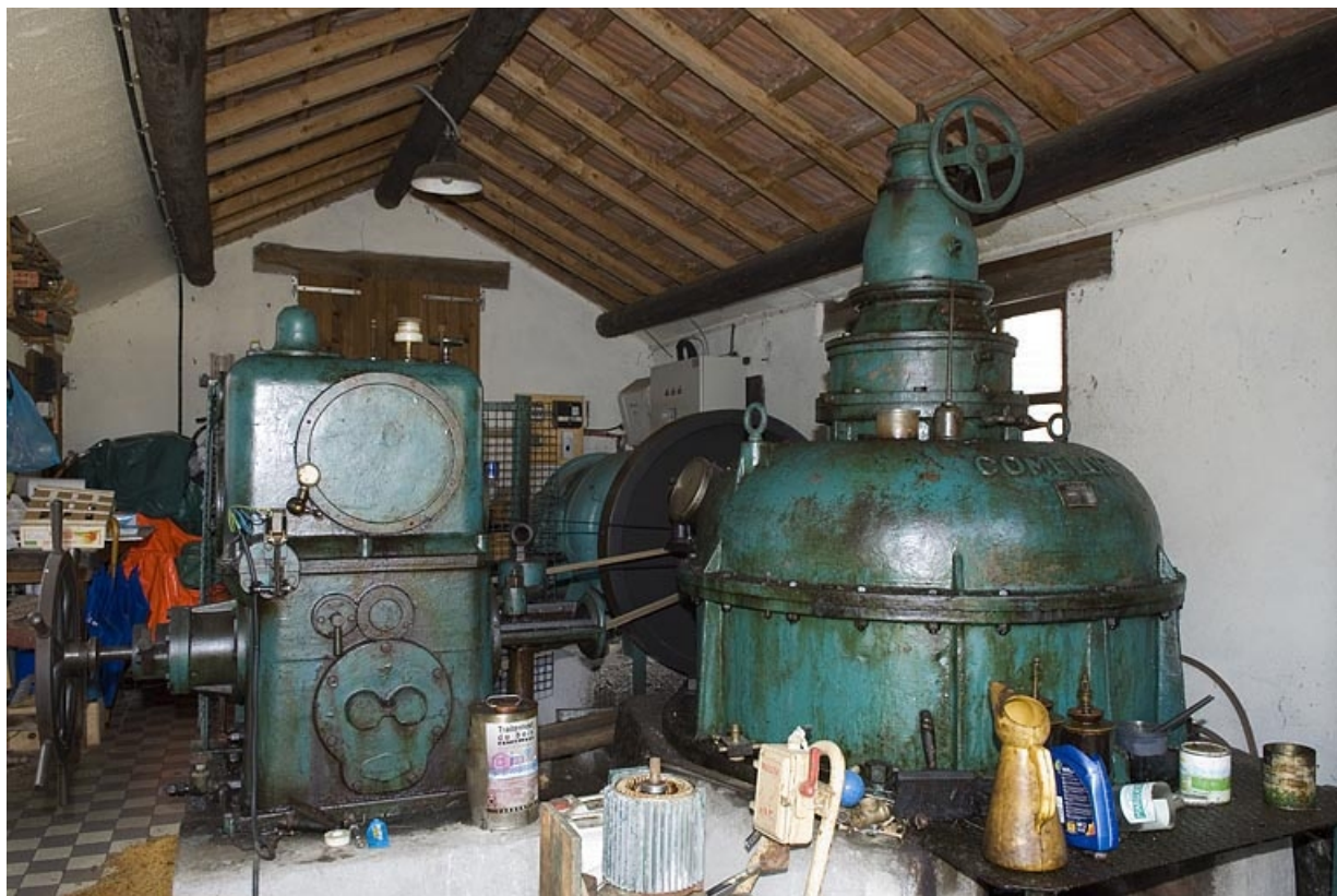
Intérieur de la salle des machines (sud). Turbine Dumont et multiplicateur Comelor. 70, Pont-du-Bois, lieudit : la Forge
