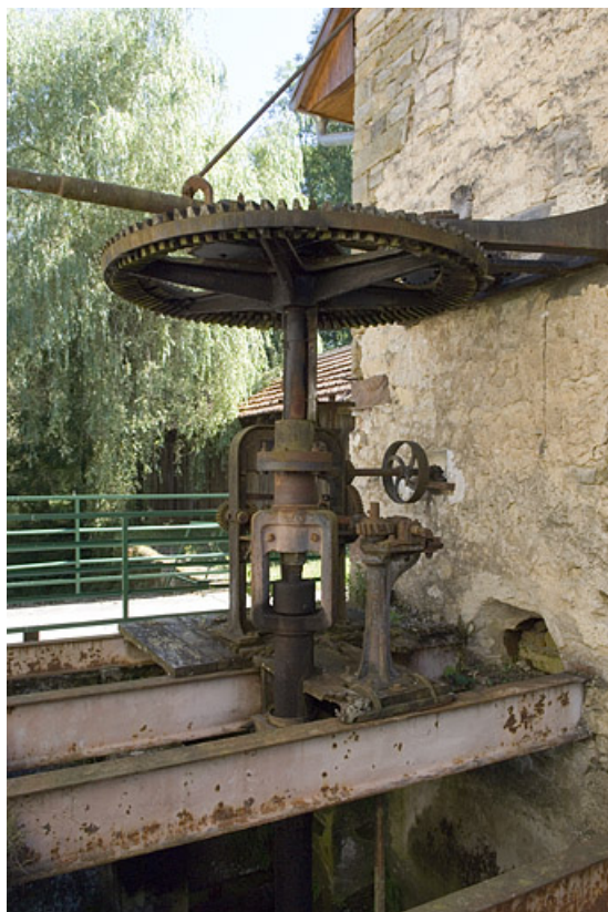
Turbine hydraulique. Partie supérieure de la transmission.
