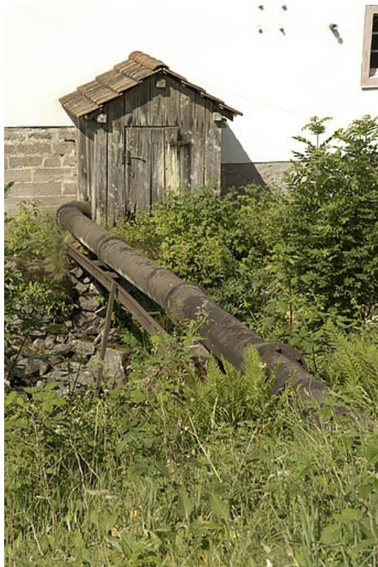
Conduite forcée et bâtiment d'eau abritant la turbine.
