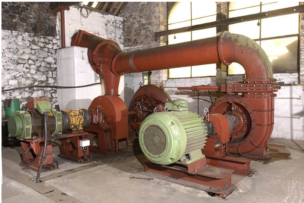
Forge du Haut. Vue d'ensemble des turbines.
