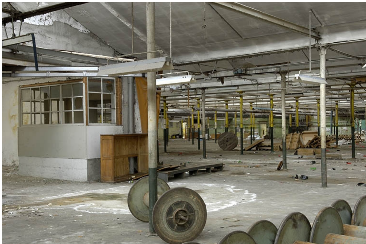
Cabine située à l'entrée de la salle de tissage. 70, Héricourt, 5, 7 rue du 11 novembre
