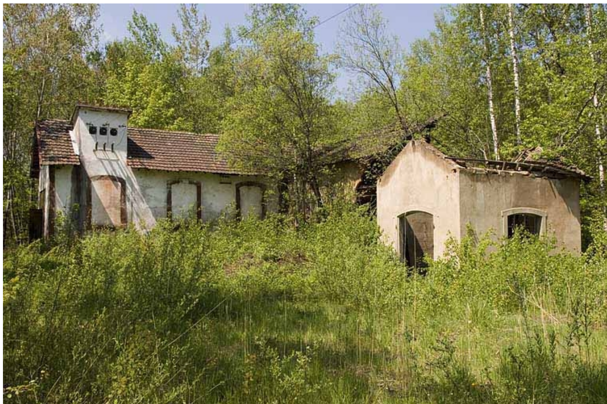
Bâtiment et transformateur de l'usine de produits chimiques.
