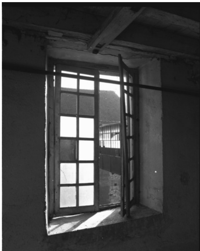
Détail d'une fenêtre du 4e niveau du moulin de commerce en 1989. 70, Port-sur-Saône rue Gilberte Lavaire
