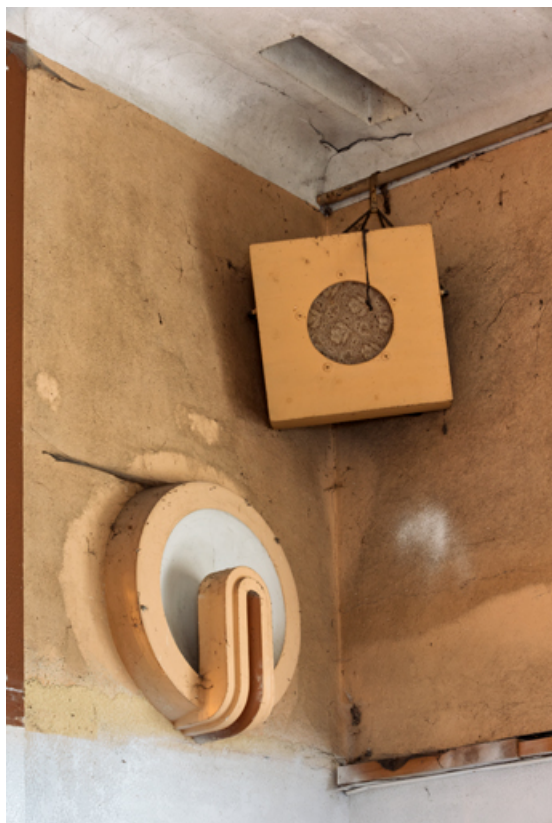
Luminaire d'applique et haut-parleur.
