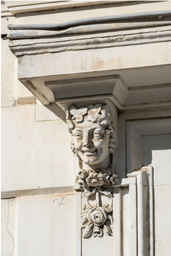
Façade de la maison de Marien dit Georges Bigouret, porte d'entrée, tête allégorique de l'automne. 58, Pougues-les-Eaux, 34 avenue de Paris
