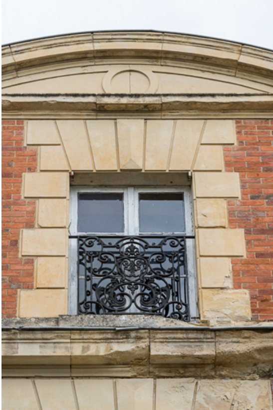
Façade sur l'avenue de Paris, détail, baie de la lucarne-pignon. 58, Pougues-les-Eaux, 6A avenue de Paris
