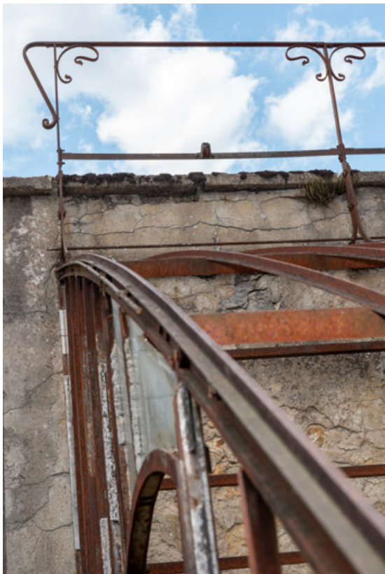
Détail de la structure métallique et du garde-corps de la galerie du mur.
