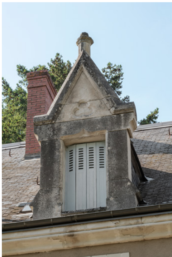
Lucarne centrale du versant sud-est de la toiture. 58, Saint-Honoré-les-Bains, 27 avenue Eugène Collin
