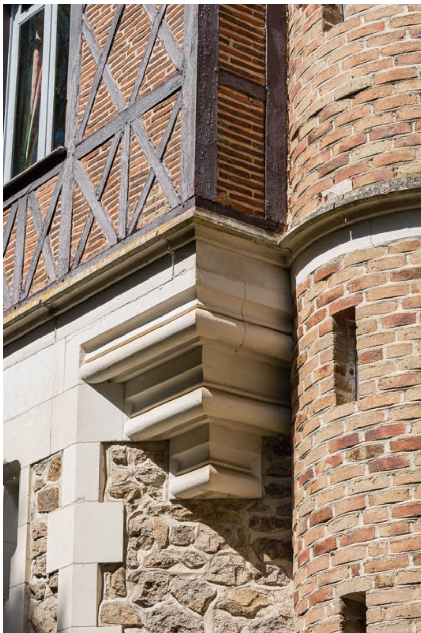
Culot de la tour d'angle supportant le troisième niveau en bois et brique.
