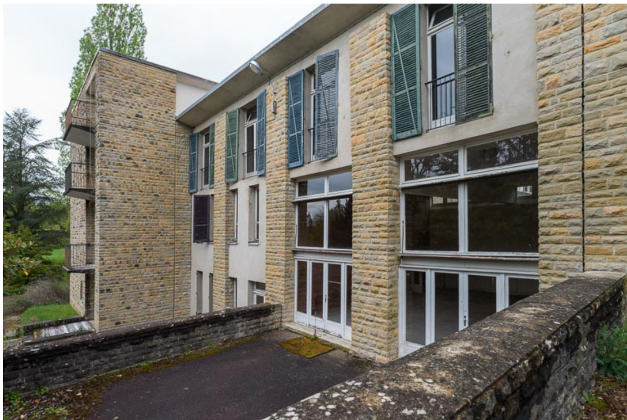
Élévation extérieure de l'aile Régina, côté sud, jonction avec le corps de bâtiment principal. 58, Saint-Honoré-les-Bains, 20 avenue Jean Mermoz
