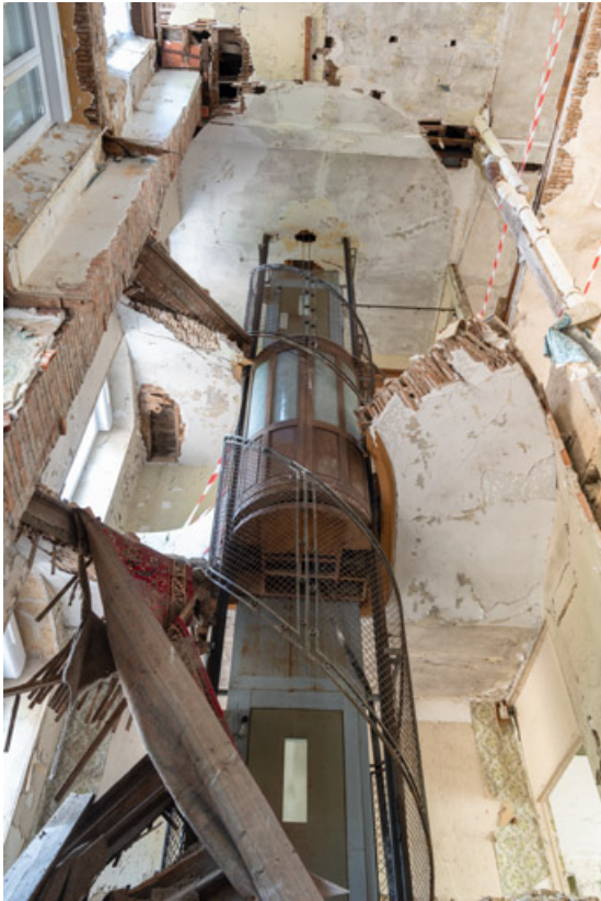
Ascenseur de l'escalier ouest, vue d'ensemble après l'effondrement des planchers. 58, Saint-Honoré-les-Bains, 9 avenue Jean Mermoz
