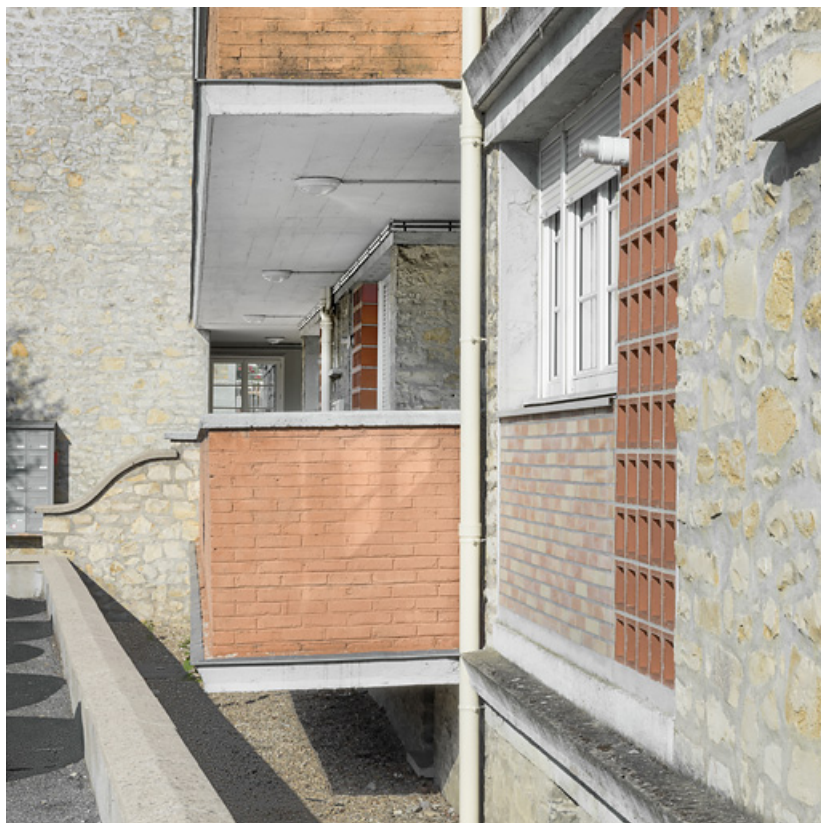
Bâtiment D : façade antérieure, galerie de desserte du rez-de-chaussée. 58, Nevers rue de Gonzague
