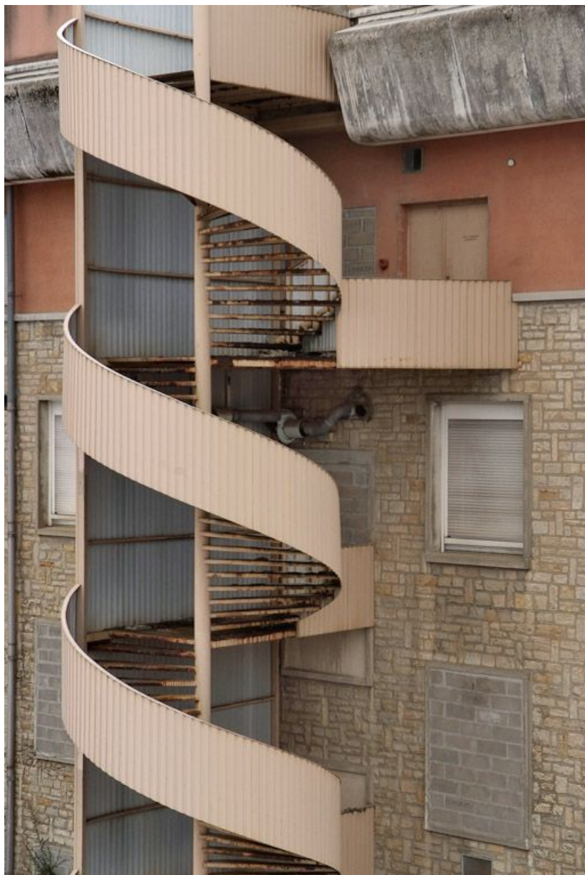
Aile postérieure du Bâtiment Inconnu (service de radiologie) : détail d'une cage d'escalier. 58, Nevers Colbert
