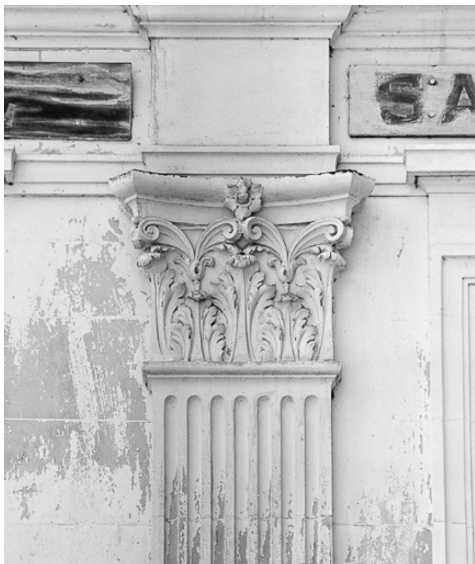
Bâtiment thermal Saint-Léger, façade antérieure : détail d'un pilastre. 58, Pougues-les-Eaux, 23-25 avenue de Conti
