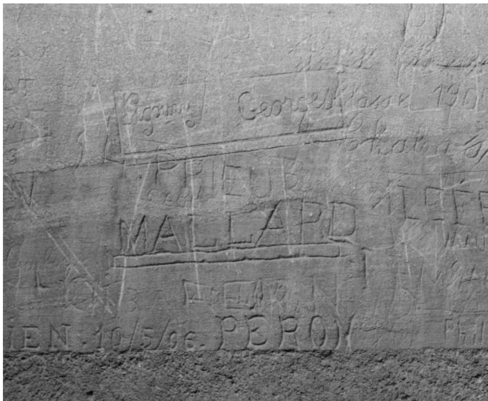
Graffitis sur le chaînage d'angle de la façade postérieure de l'aile militaire du bâtiment principal. 58, Cosne-Cours-sur-Loire, 96 rue du Maréchal-Leclerc
