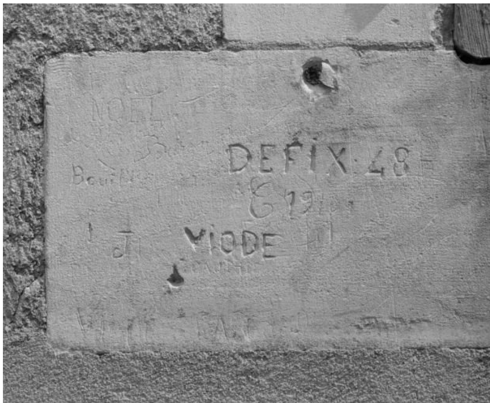
Graffitis sur le chaînage d'angle de la façade latérale de l'aile militaire du bâtiment principal. 58, Cosne-Cours-sur-Loire, 96 rue du Maréchal-Leclerc
