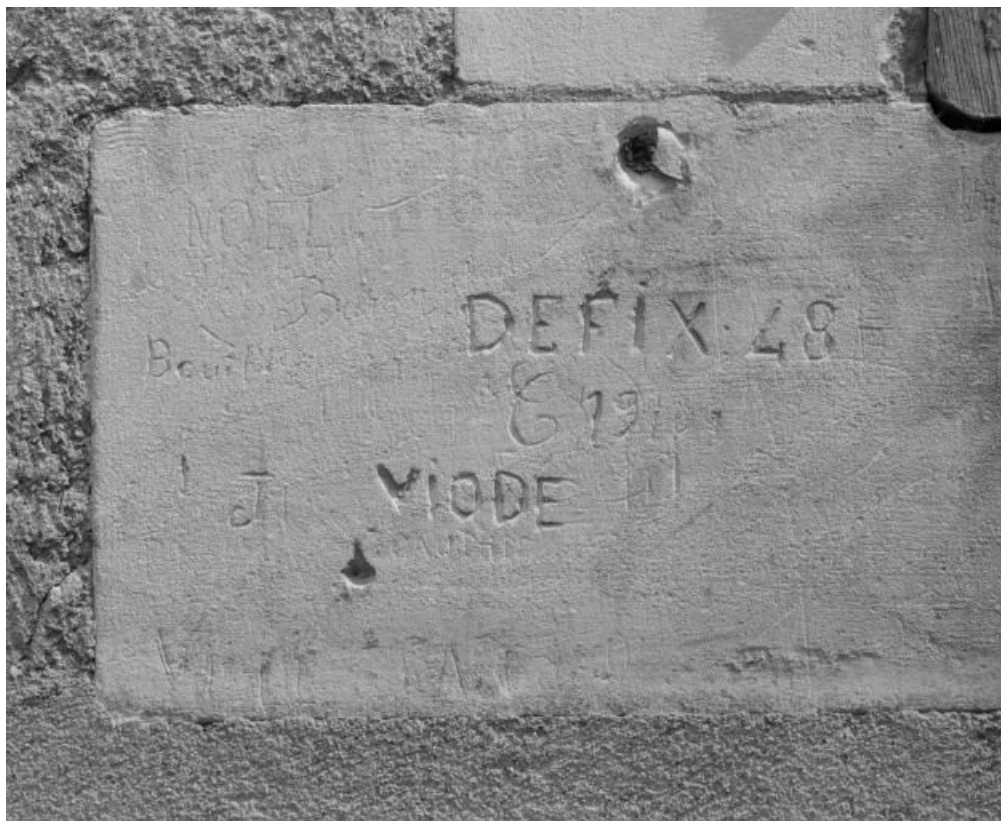
Graffitis sur le chaînage d'angle de la façade latérale de l'aile militaire du bâtiment principal. 58, Cosne-Cours-sur-Loire, 96 rue du Maréchal-Leclerc
