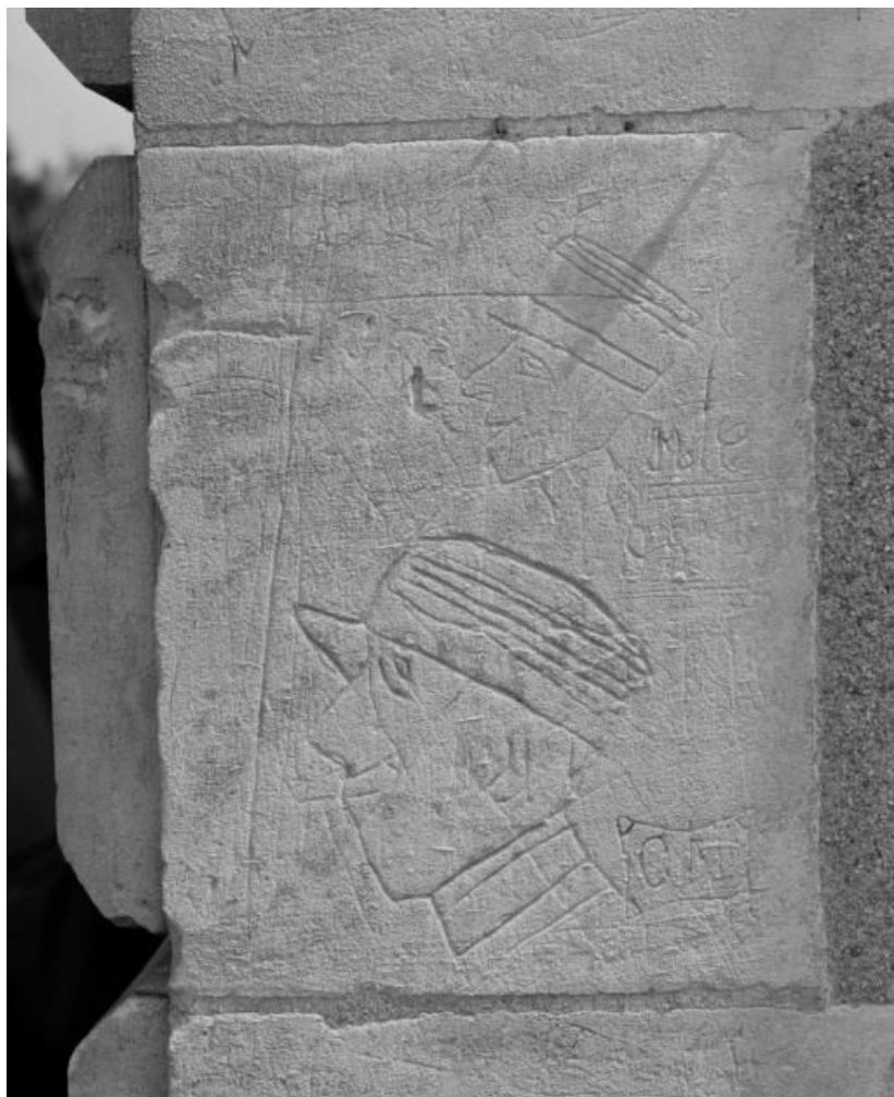
Graffitis sur le chaînage d'angle de la façade latérale de l'aile militaire du bâtiment principal. 58, Cosne-Cours-sur-Loire, 96 rue du Maréchal-Leclerc
