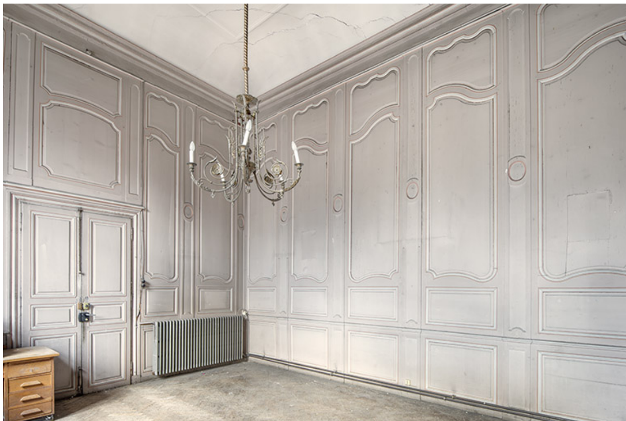
Aile nord. Pièce au premier étage, vue de trois quarts. 39, Salins-les-Bains place des Alliés et de la Résistance
