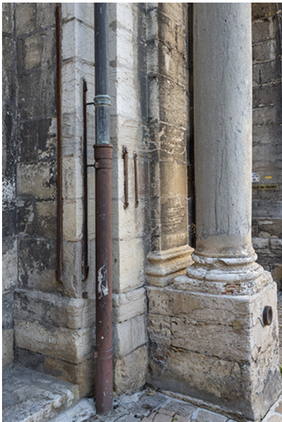
Toises métalliques (piédroit du passage couvert, corps de bâtiment principal). 39, Salins-les-Bains place des Alliés et de la Résistance
