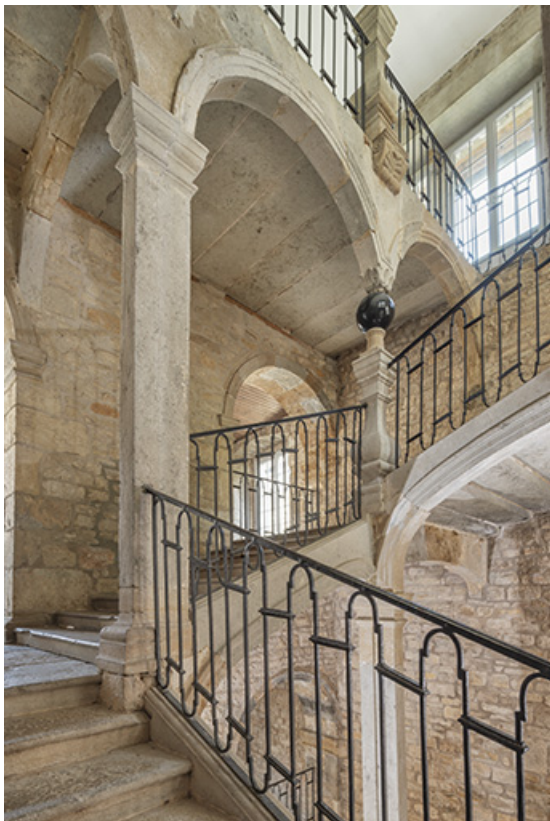
Escalier dit "aux boules de pierre". Vue de la partie supérieure depuis le premier étage. 39, Salins-les-Bains, 9 rue du Temple
