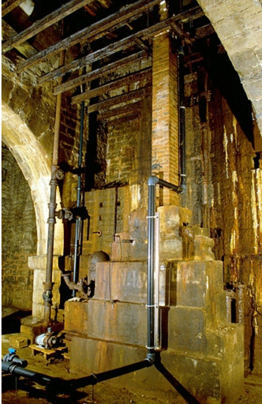
Massif de maçonnerie du puits à Muire supportant les installations de pompage. À gauche, les anciennes canalisations de remontée de l'eau salée (hors d'usage).
