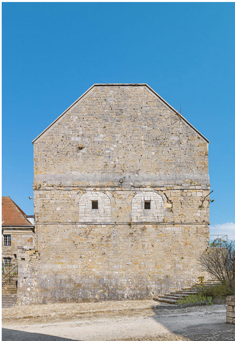
Caserne U : mur pignon épaissi, au cours du 19e siècle pour être à l'épreuve des bombes.
