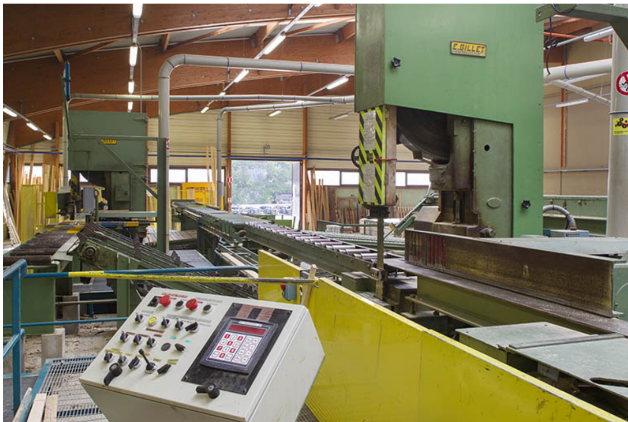
Scierie : poste de commande automatisé.
