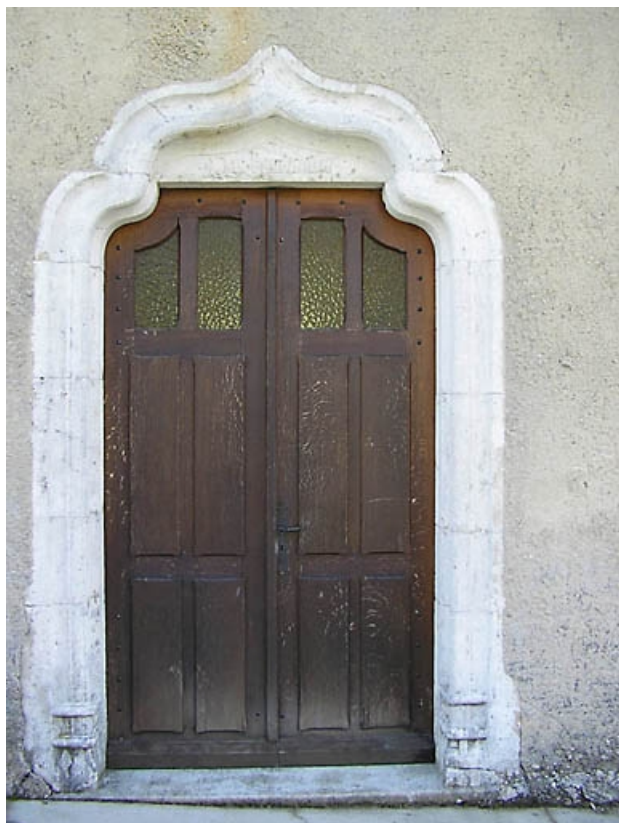
Vue de la porte et de son encadrement avec arc en accolade.
